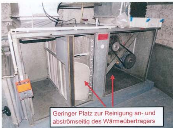
Bild 1: Außenansicht einer Zuluftanlage im Objekt „Schlangebader Straße“ (beispielhaft)
