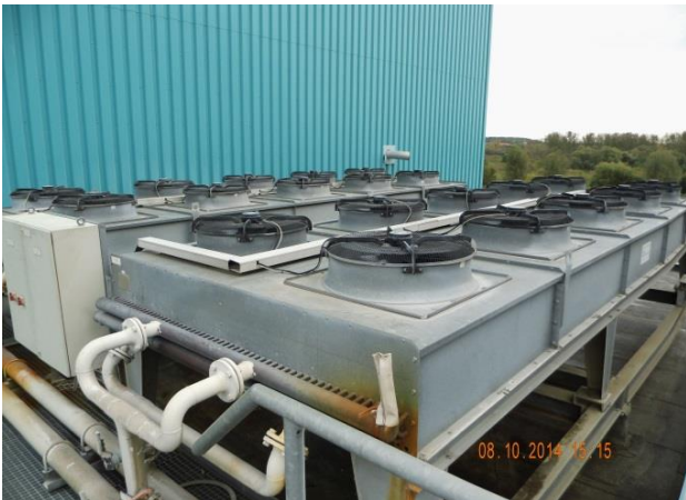
Bild 1: Ansicht beider Rückkühlanlagen von oben
