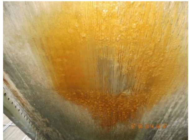
Bild 2: Ansicht Rückkühler (Ausschnitt) von unten vor der Entkalkung
