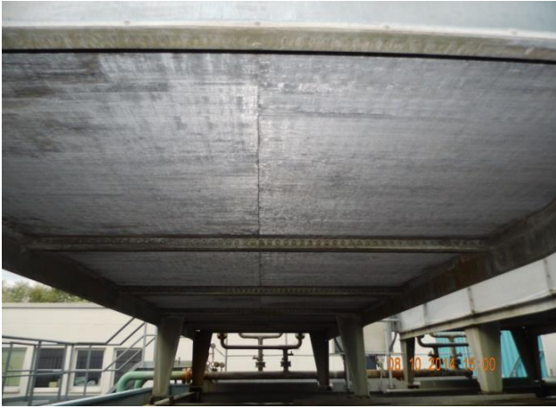
Bild 3: Ansicht Rückkühler von unten nach der Entkalkung
