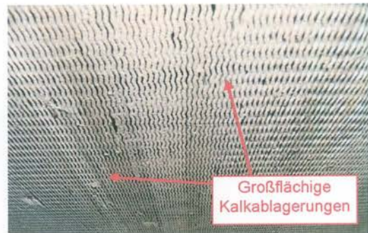
Bild 2: Ansicht Rückkühler (Ausschnitt) von unten vor der Entkalkung
