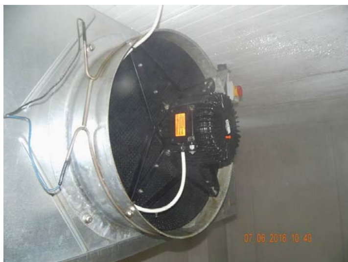
Foto 6: Verdampfer 14 – Tiefkühlung -23°C - nach der Hygiene-Reinigung
