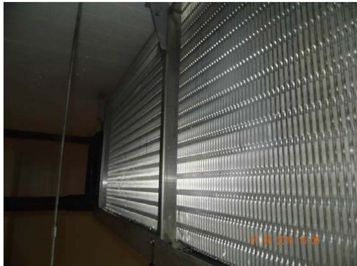
Foto 5: Verdampfer 14 – Tiefkühlung -23°C - nach der Hygiene-Reinigung
