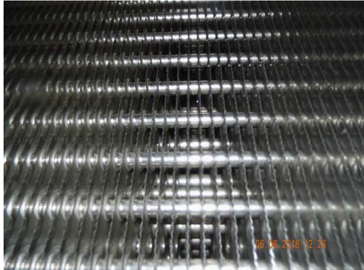
Foto 4: Verdampfer 13 – Tiefkühlung -23°C - nach der Hygiene-Reinigung
